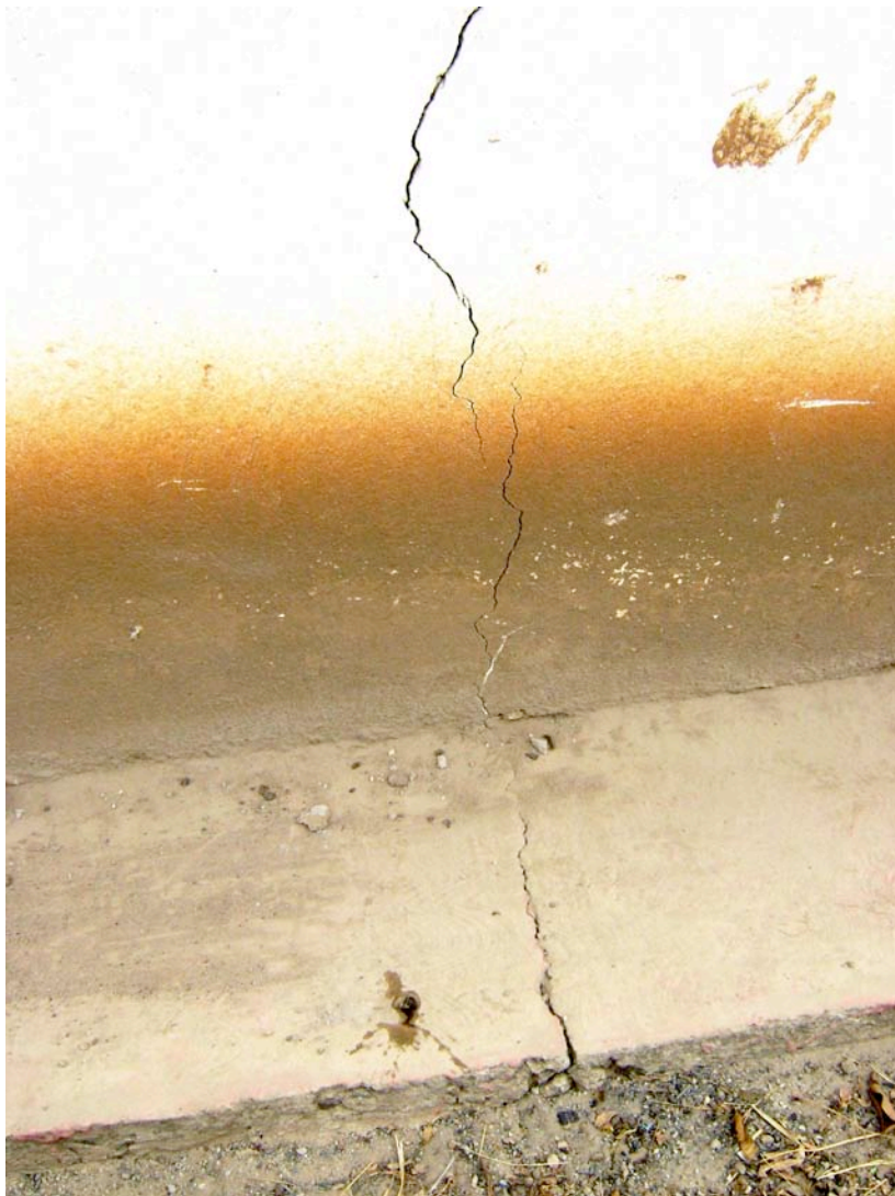
Figura 5c Tipo 3 Rajadura en Pared y Losa
