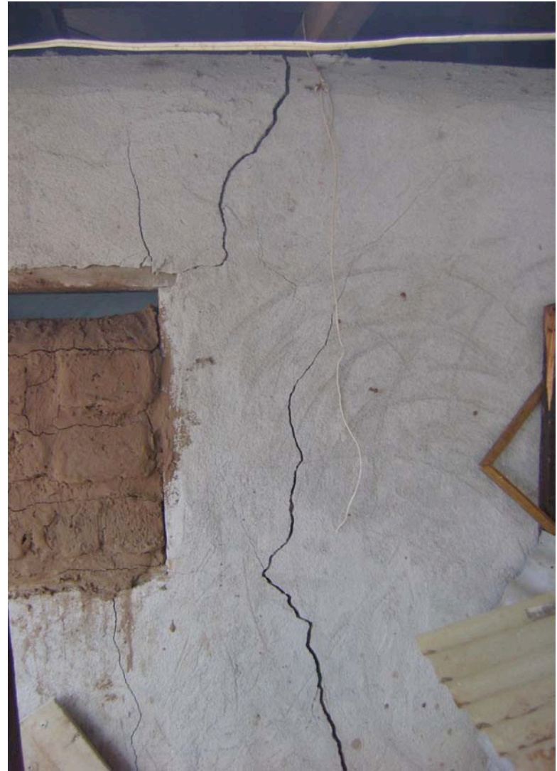
Figura 1b Rajaduras Verticales en Pared en Adobe
