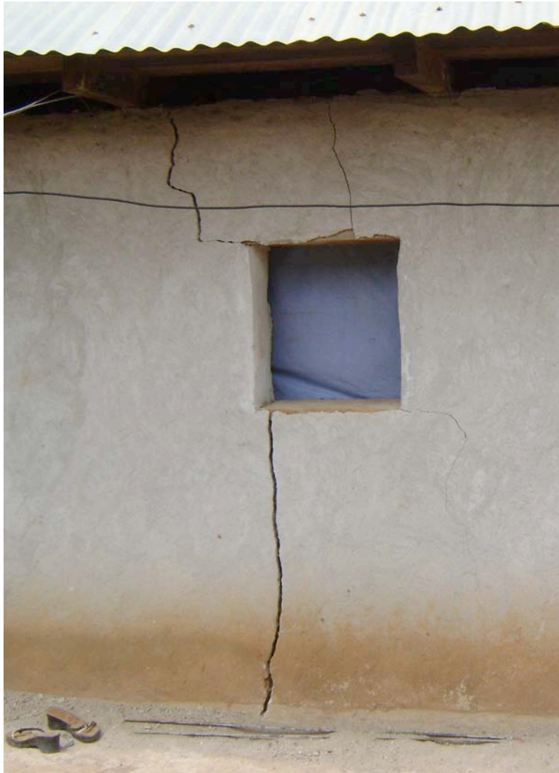
Figura 1a Rajaduras Verticales en Pared en Adobe
