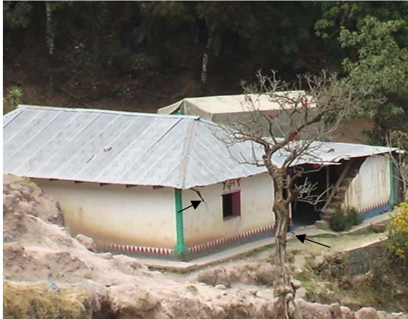
Figura 9a Casa Dañada (vea agujero en pared, flecha a la izquierda apunta hacia rajadura de pared, flecha al derecho apunta hacia fractura que se extiende en frente)
