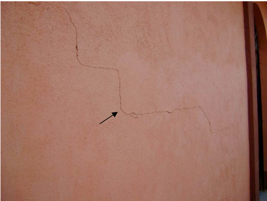
Figura 1d Rajaduras en Lechada en Bloques de Concreto
