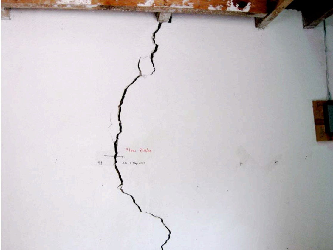
Figura 5e Tipo 5 Rajadura en Pared Debajo de Viga de Techo
