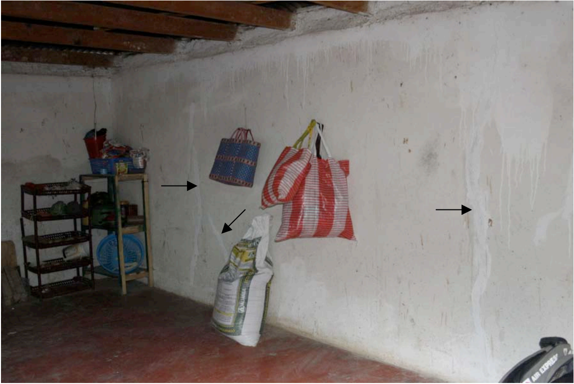
Figura 5a Tipo 1 Rajaduras en Pared (3 Cubiertos con Yeso), No Rajaduras en Losa
