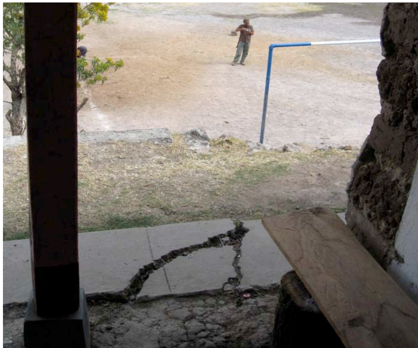
Figura 9b Vista de Casa en Figura 9a (Fractura en frente es la misma mostrada en Figura 9a y extiende hasta persona. Fractura es difícil ver ya que está llena parcialmente con suelo)
