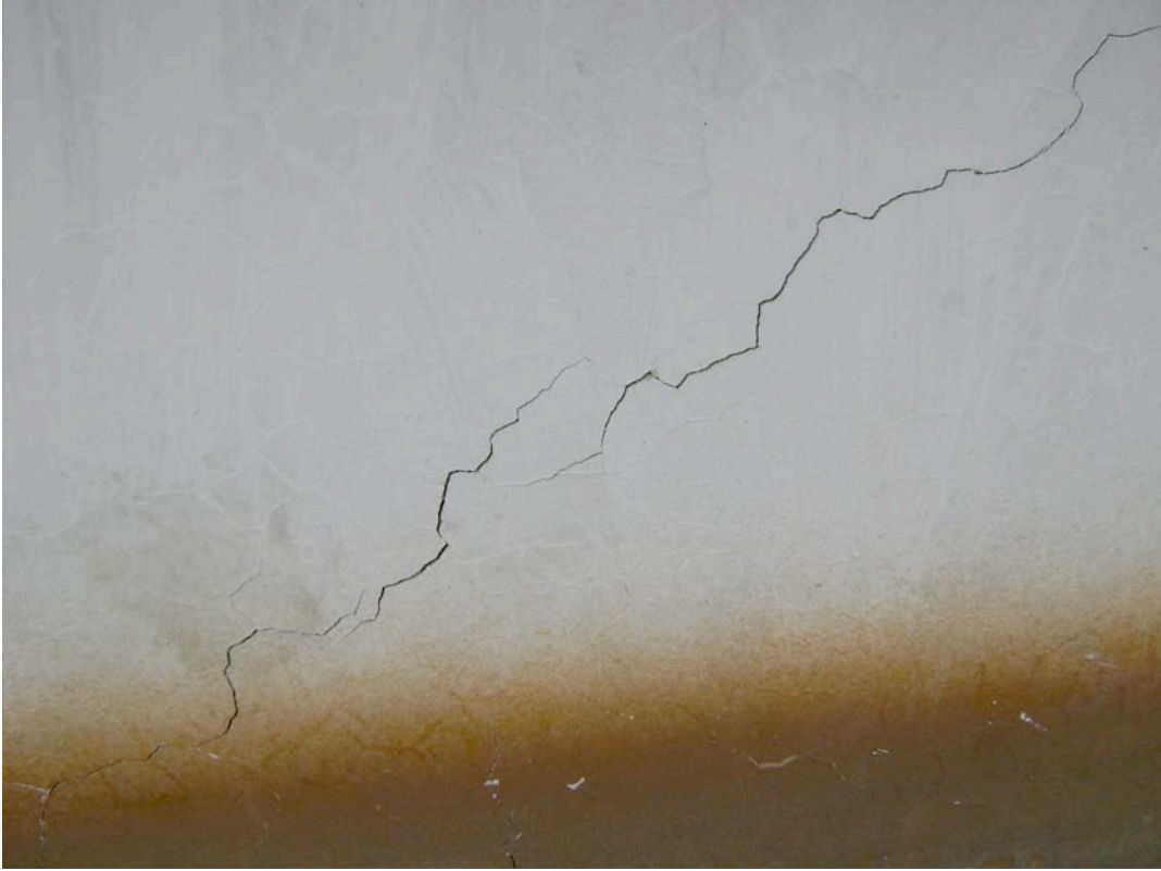
Figura 1c Rajadura Inclinada en Adobe
